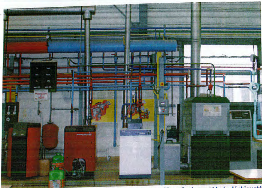
Le lycée dispose de chaudières fioul, gaz et bois déchiqueté.
